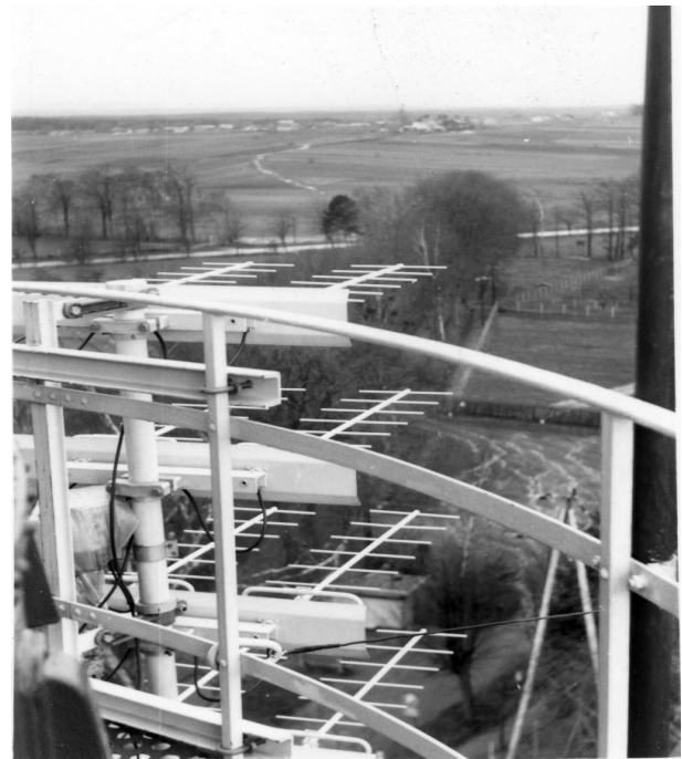
Abb. 27. UHF-Antenne am Leuchtturm Rozewie nördlich Danzig.
